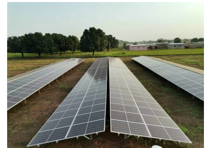
Ländliche Elektrifizierung in Mali
